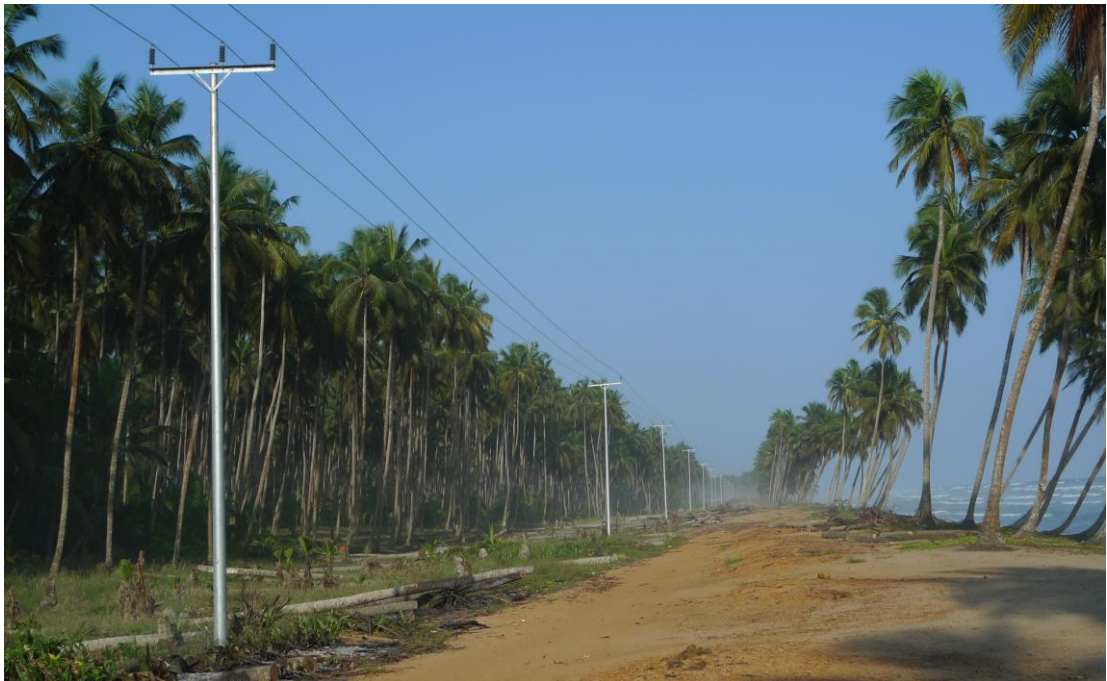
加纳电气化 4 期附属工程低压部分
