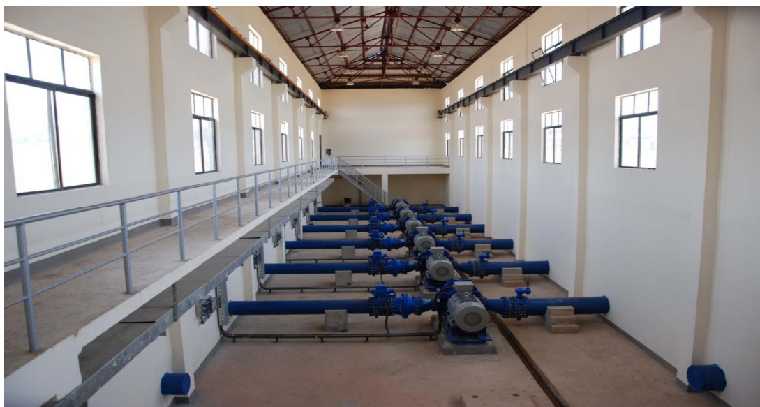
洛科贾 LOKOJA 水厂送水泵站
