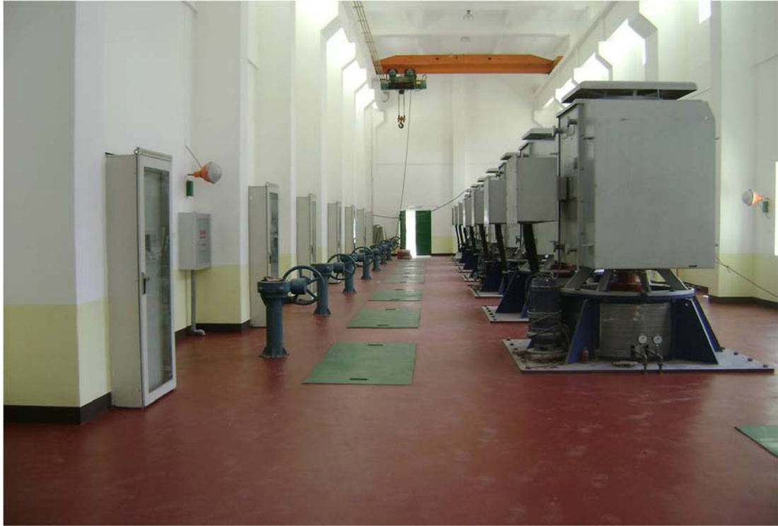
泵房内的 7 台长轴立式混流泵
