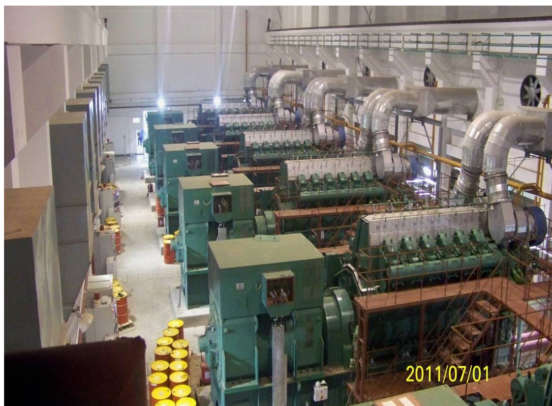
主厂房内主机机组
