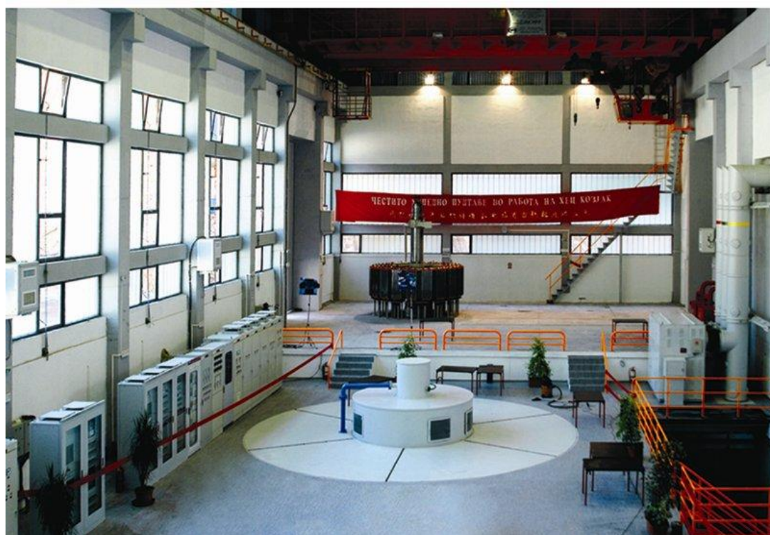
马其顿水电站发电厂房内景
