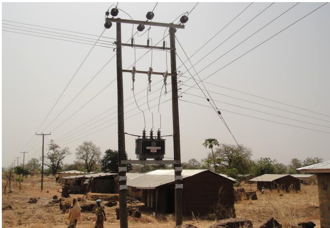
由分包商施工的变压器及高低压线路
