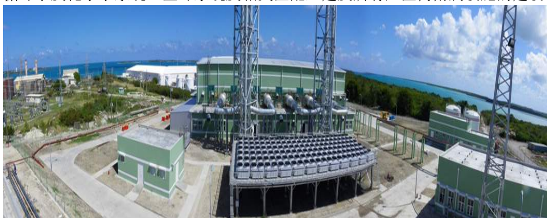
安巴电厂竣工后全景
